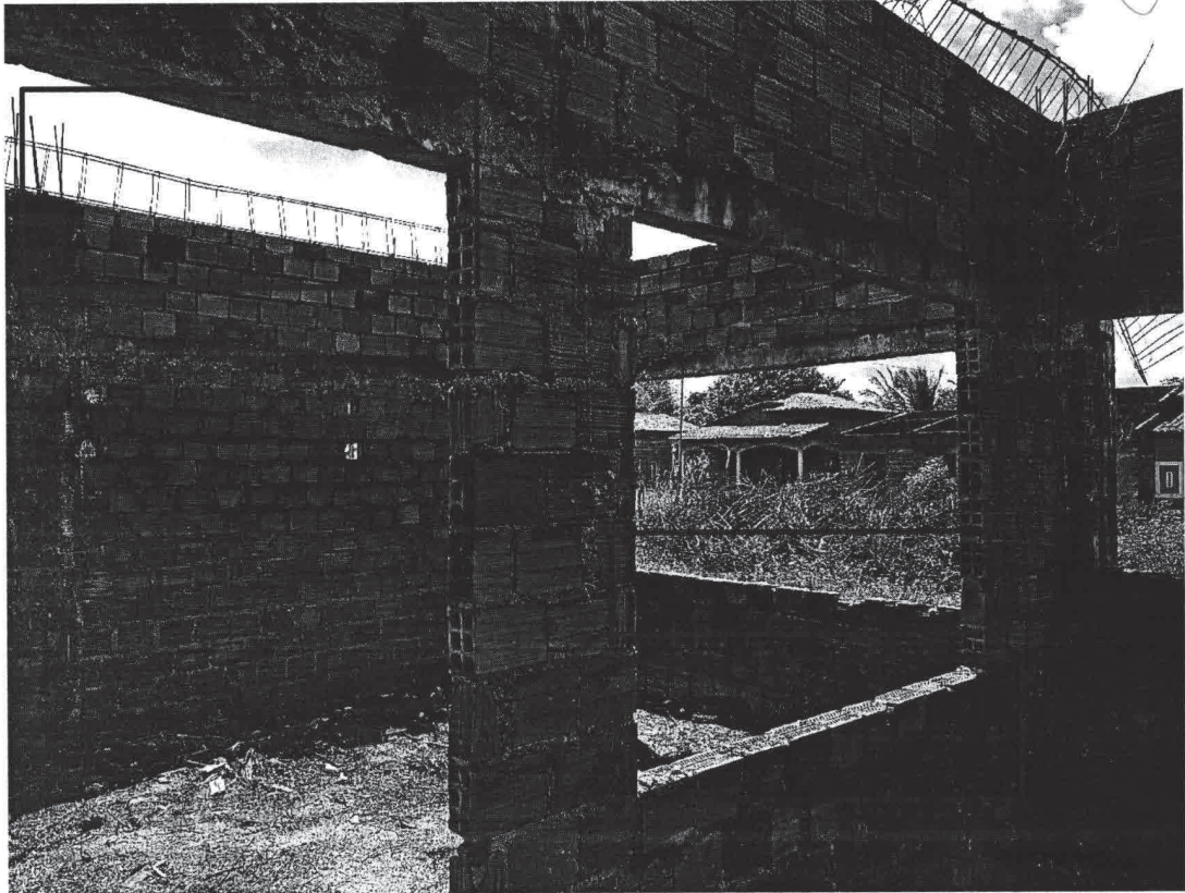
Imagem evidenciando armaduras de vigas posicionadas e ausência de contra-vergas.
